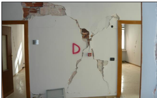
Figura 4 – Rottura delle tramezze interne
